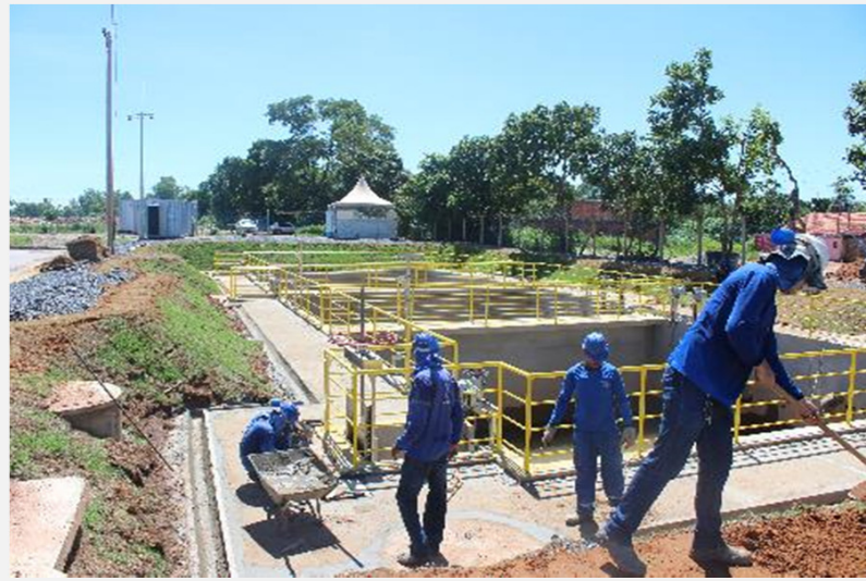
Sistema de Tratamento de Lodo ETA Sul
