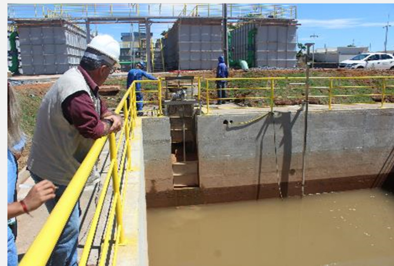
Tanque de pré sedimentação de lodo
