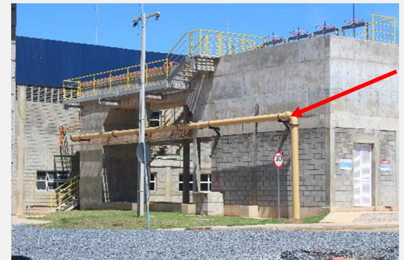
Tubulação de recirculação do lodo
