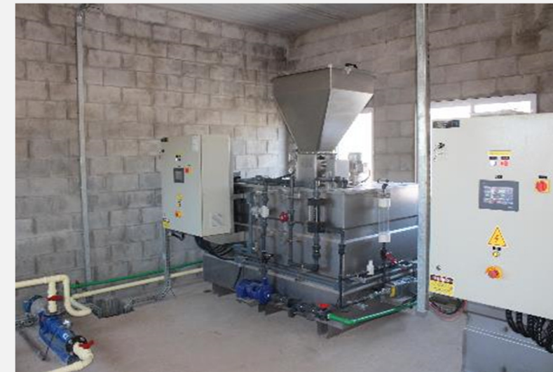
Tanques de preparo do polímero do lodo
