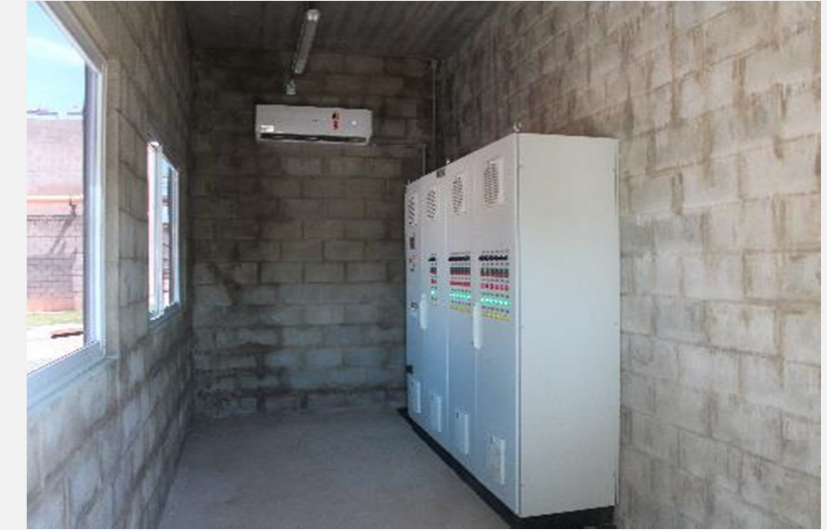
Painéis de controle e automação
